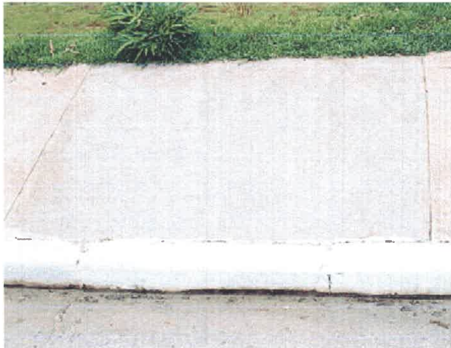
Figura 4: Calçada com juntas de dilatação
