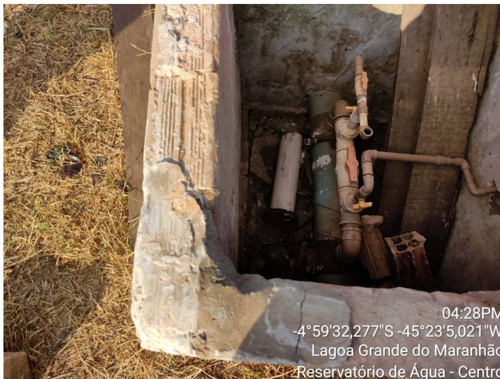
Imagem 8: Caixa do Clorador (desativado)
