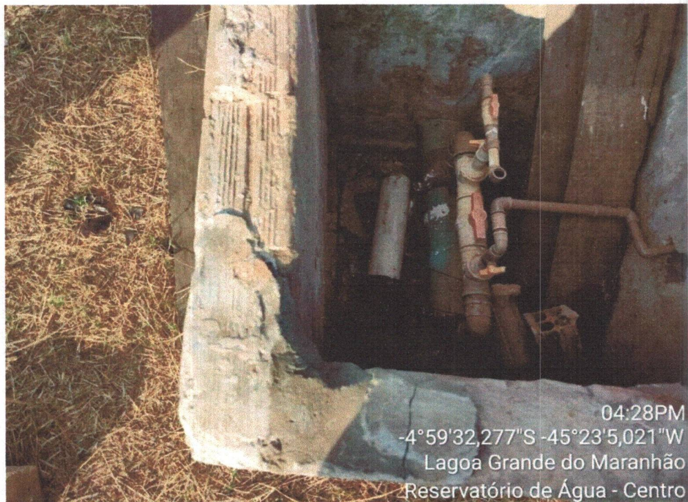
Imagem 8: Caixa do Clorador (desativado)
