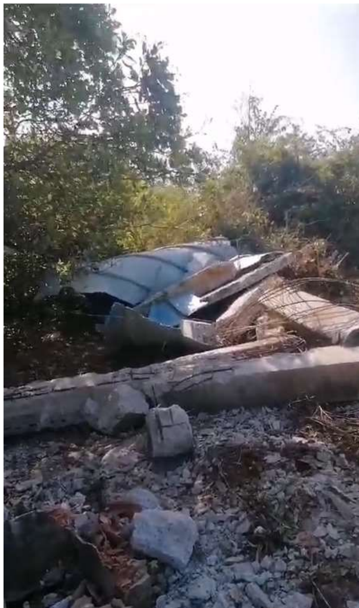
Foto 1: Estrutura atual desabada
