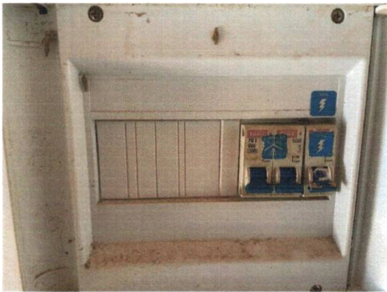
Figura 15: Quadro de Distribuição
