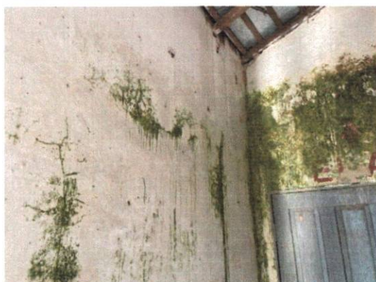
Figura 5: Infiltração em parede
