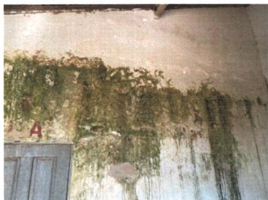
Figura 4: Infiltração em parede do banheiro
