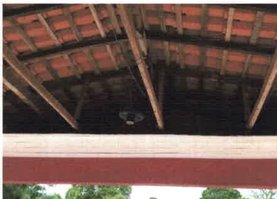
Figura 3: Fachada principal sem forro
