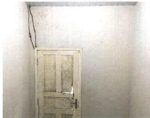
Figura 4: porta danificada com cupim
