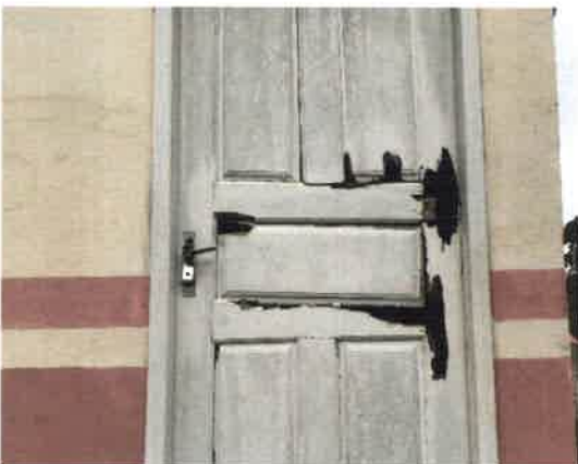
Figura 11: Portas com preseça de cupim
