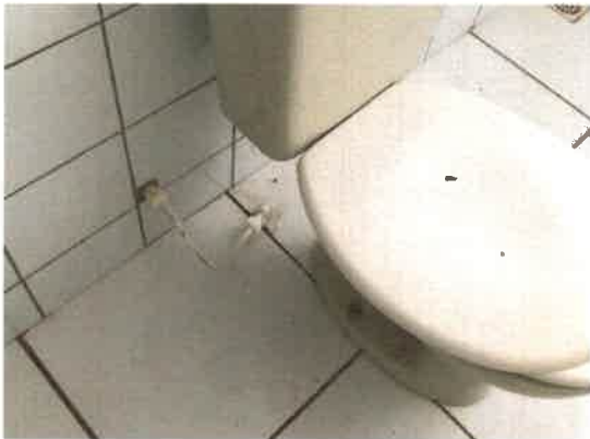
Figura 9: Bacia sanitária com defeito
