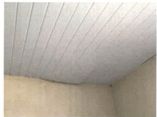
Figura 10: Forro com defeito
