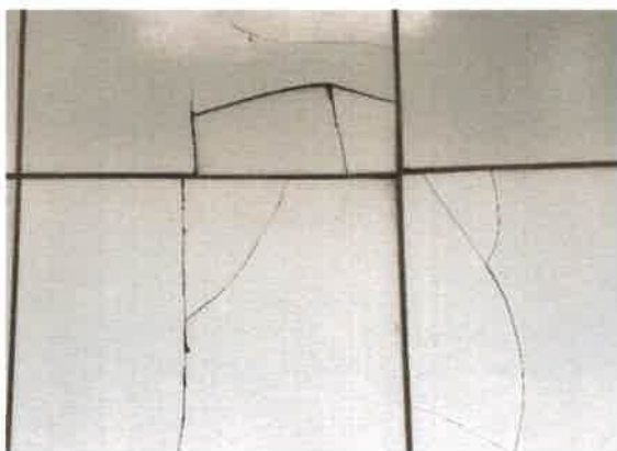
Figura 5: Rachaduras no revestimento cerâmico do piso
