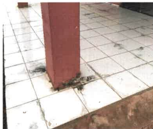
Figura 2: Infiltração no piso
