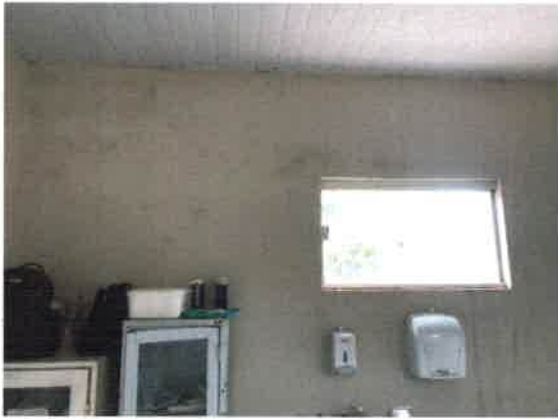
Figura 7: Infiltração nas paredes
