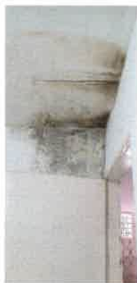
Figura 3: Infiltração e defeito no forro
