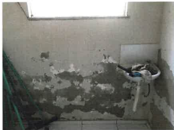
Figura 2: DML (infiltração nas paredes)
