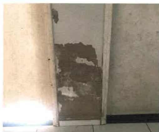
Figura 11: Portas de Madeira desgastadas
