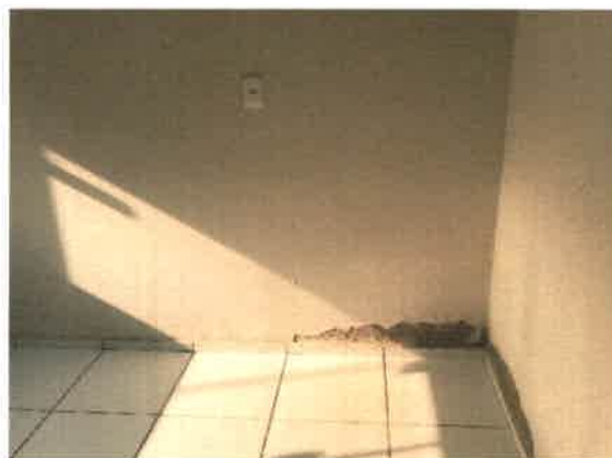
Figura 8: Infiltração nas proximidades do rodapé
