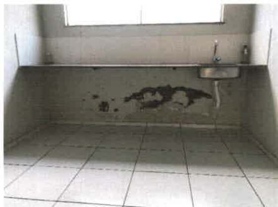
Figura 5: Pintura desgastada (infiltração)
