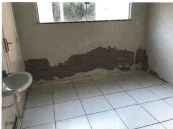
Figura 7: Infiltração nas paredes
