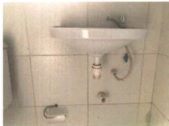
Figura 2: Tubos de louça incompletos
